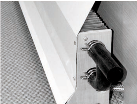
Kuva 85: Konvektori ja lämmönjohtopelti
