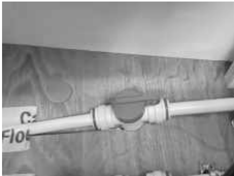
Kuva 91: Lattialämmityksen ALDE venttiili
