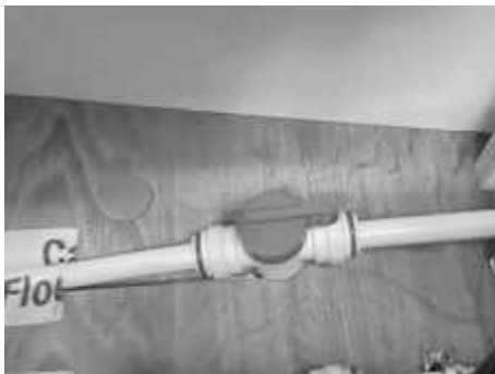
Kuva 86: Lattialämmityksen ALDE venttiili
