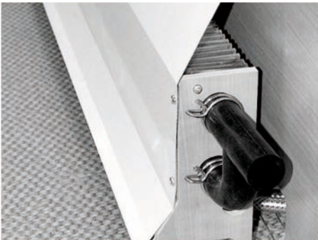
Kuva 84: Konvektori ja lämmönjohtopelti
