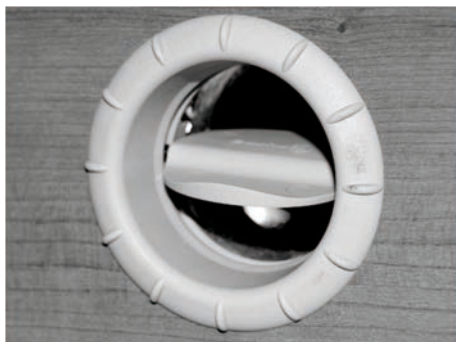
Fig. 72: Bocchetta dell'aria calda aperta
