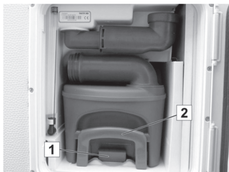
Abb. 172: Fäkalientank im Entsorgungsschacht
