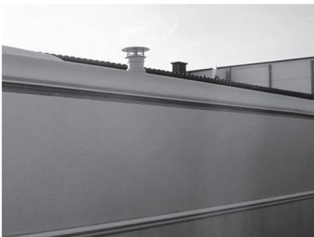
Abb. 82: Abgaskamin der Gasheizung
