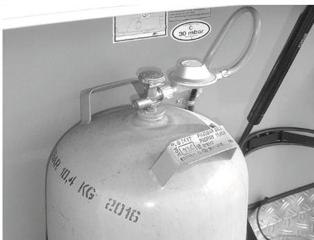
Abb. 71: Gasflasche mit Niederdruckregler und Niederdruckschlauch
