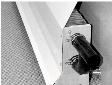
Kuva 83: Konvektori ja lämmönjohtopelti
