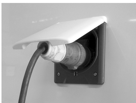
Fig. 2: Allacciamento alla rete elettrica
