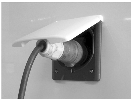
Fig. 2: Allacciamento alla rete elettrica
