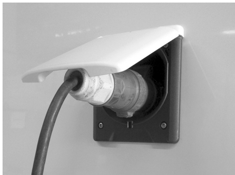
Fig. 56: Allacciamento alla rete elettrica
