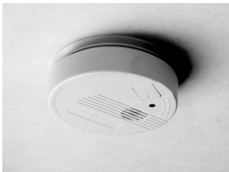
Fig. 41: Rivelatore di fumo
