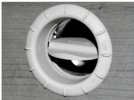
Fig. 129: Bocchetta dell'aria calda aperta
