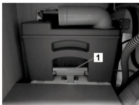
Fig. 195: Serbatoio acque nere nel vano WC
