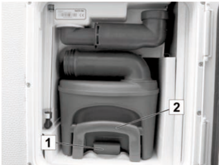
Fig. 192: Serbatoio acque nere nel vano WC
