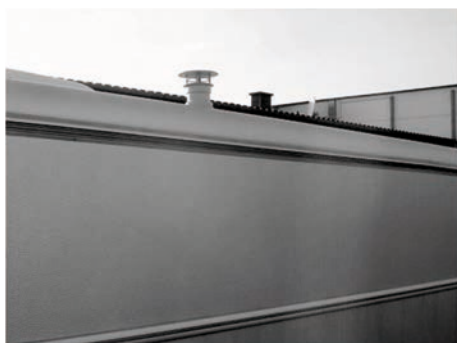
Fig. 77: Camino di scarico del riscaldamento a gas
