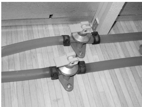
Fig. 171: Valvole di scarico chiuse
