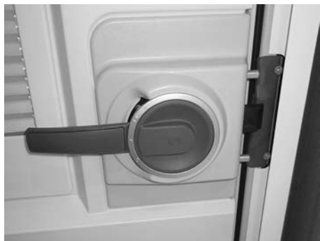
Fig. 15: Serratura della porta chiusa, ma non bloccata
