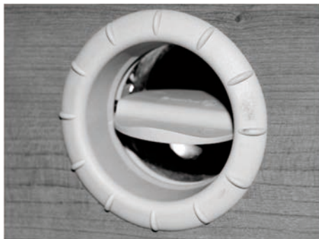
Fig. 76: Bocchetta dell'aria calda aperta
