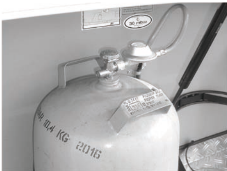
Fig. 70: Bombola di gas con pressostato di bassa pressione e tubo flessibile per bassa pressione
