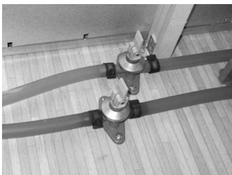
Fig. 97: Valvole di scarico aperte
