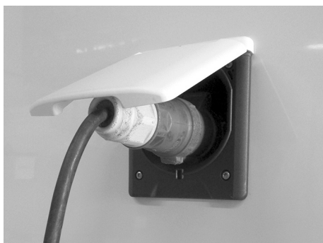
Fig. 2 : Branchement électrique sur le secteur
