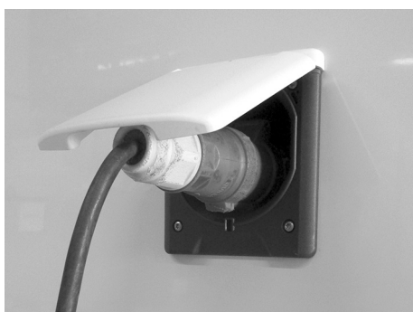
Fig. 2 : Branchement électrique sur le secteur
