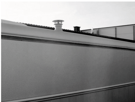
Abb. 95: Abgaskamin der Gasheizung
