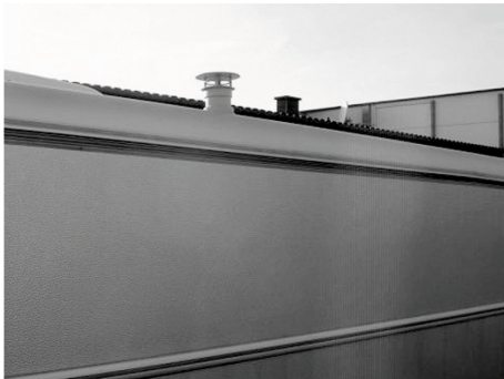
Abb. 84: Abgaskamin der Gasheizung
