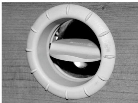
Fig. 136: Bocchetta dell'aria calda aperta
