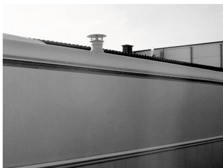
Fig. 95: Camino di scarico del riscaldamento a gas
