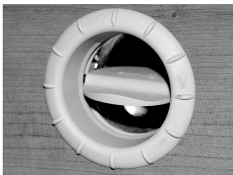
Fig. 94: Bocchetta dell'aria calda aperta
