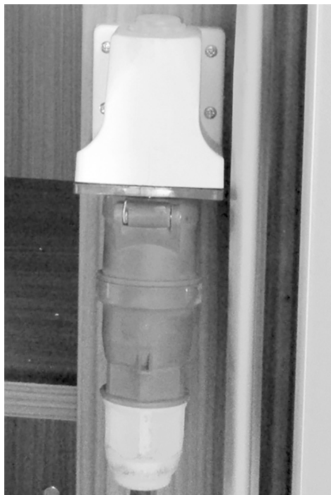
Fig. 51 : Branchement électrique sur le secteur
