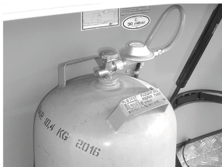
Abb. 74: Gasflasche mit Niederdruckregler und Niederdruckschlauch
