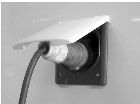
Fig. 60 : Branchement électrique sur le secteur
