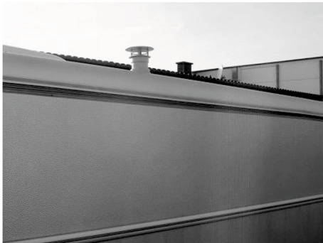
Abb. 95: Abgaskamin der Gasheizung
