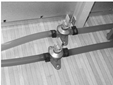
Fig. 97: Vannes de vidange ouvertes
